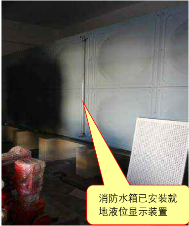
消防水池已安装就地液位显示装置
