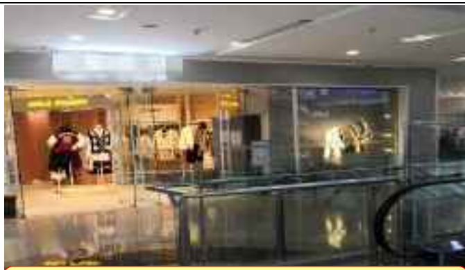
中庭部位采用非隔热性防火玻璃墙分隔，未设置喷淋防护冷却系统；商铺与中庭连通的门，未采用甲级防火门，且不具备火灾时自动关闭功能
