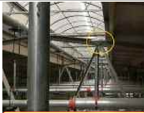
顶棚空间较高，直立型喷头溅水盘和顶棚距离过大，安装挡水板当集热罩使用，不符合规范要求
